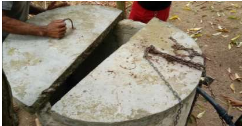
Figura 3. Vista frontal de pozo artesanal Sabanalarga: Fuente propia
