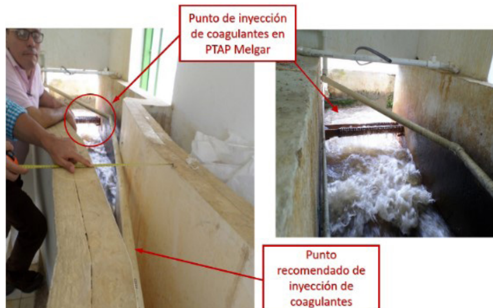
Fig. 4. Canaleta Parshall de la PTAP de Melgar - Tolima. Fuente: [3].
