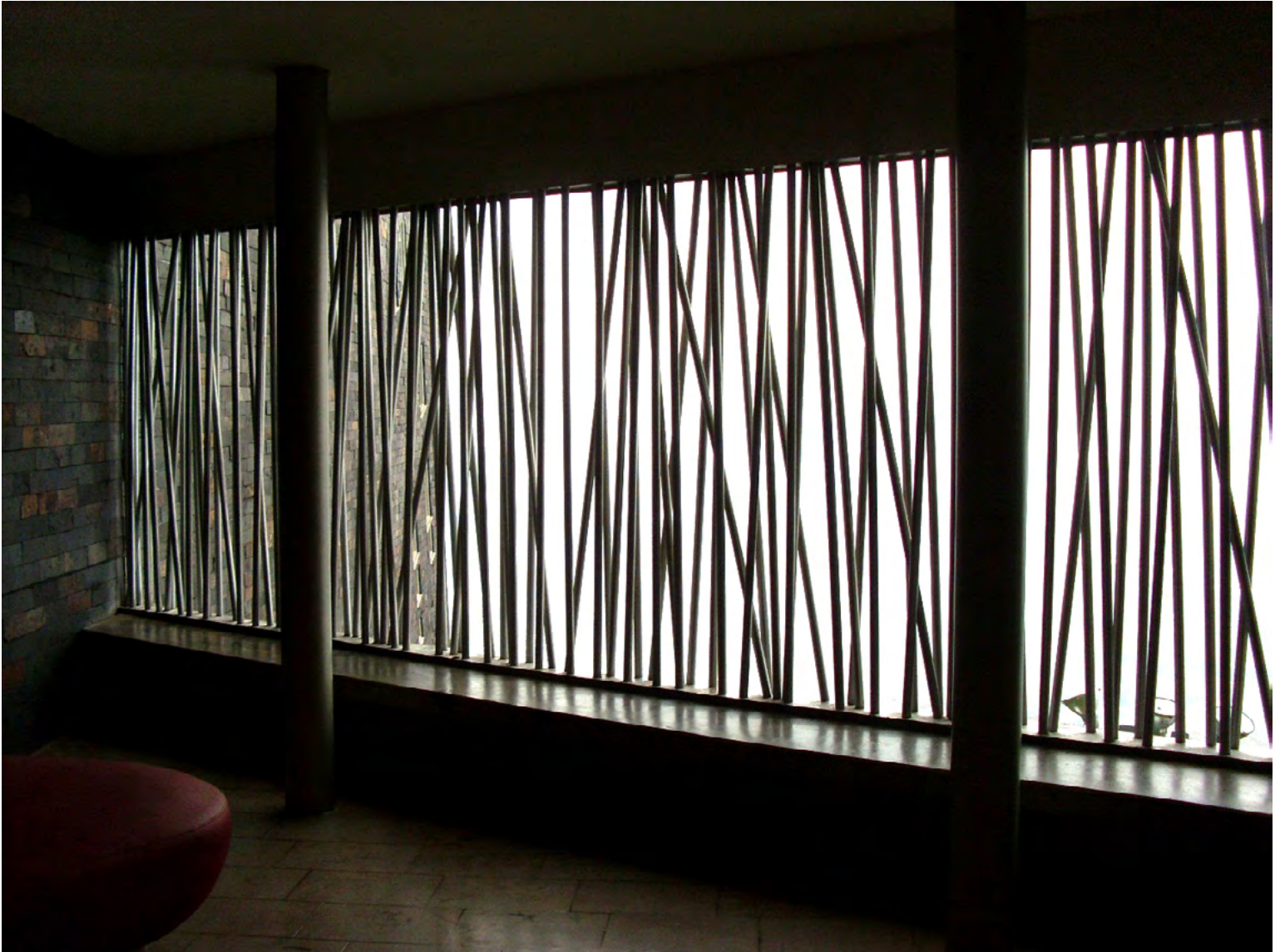
Figura 3. Parque Biblioteca España, Medellín 2009. Los elementos verticales permiten la entrada de luz de forma tamizada, dejando el espacio casi en penumbras, dándole una sensación de misterio y misticidad al espacio interior.
