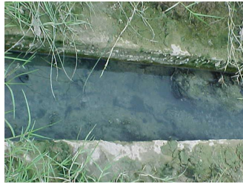
CONTAMINACION .DETALLE CANAL DE DESAGUE A.R.
