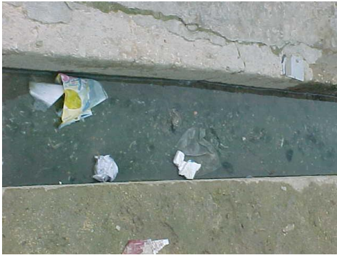
CONTAMINACION .DETALLE CANAL A.R.
