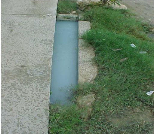
CONTAMINACION POR CANAL EVACUACION A.R. (4)
