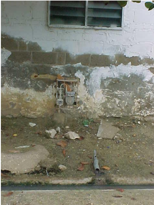
CONTAMINACION POR CANAL EVACUACION A.R. (3)
