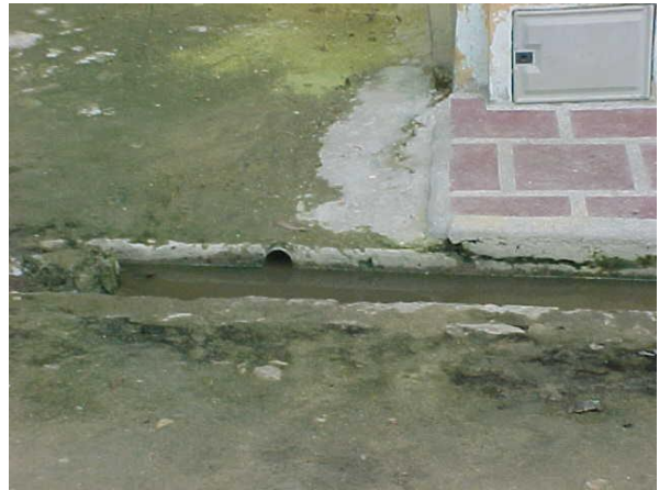
CONTAMINACION POR CANAL EVACUACION A.R. (2)
