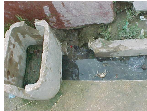
CONTAMINACION POR CANAL EVACUACION DE A.R. 1
