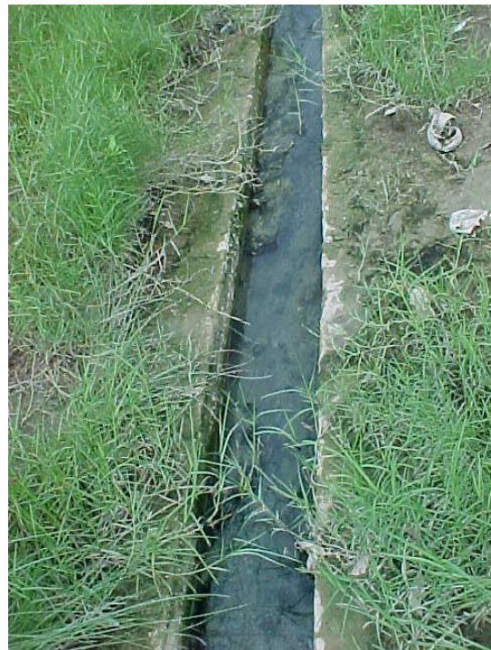
CONTAMINACION POR CANAL DE DESAGUE A.R.
