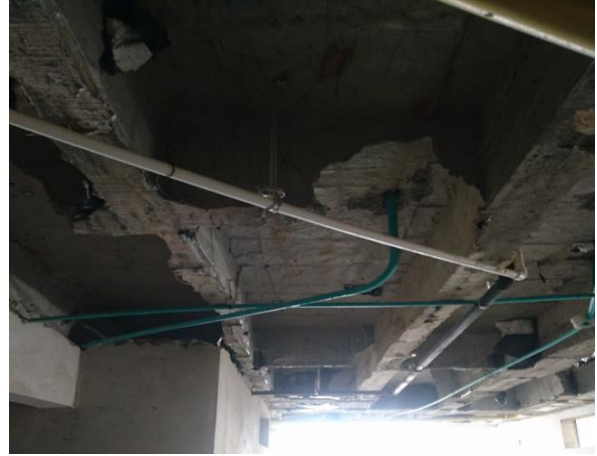
Figura 5. Discontinuidad en dimensiones en las viguetas. Por S. Coll y J. Cervantes, 2017
