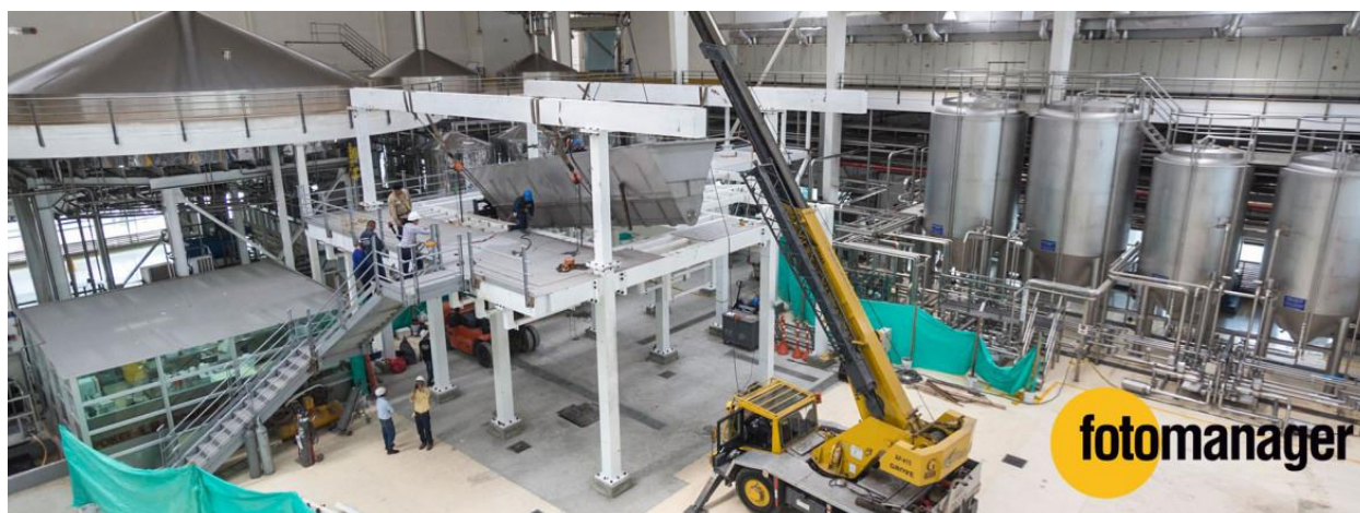
Figura 3. Cocina de la cervecera del valle. Adaptado de “Proyecto Montaje cocina continua cervecera del valle” Por fotomanager, 2015. Recuperado de http://fotomanager.co/proyectos/montaje-cocina-continua/
