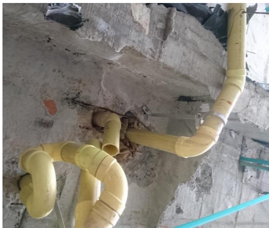
Figura 8. Exposición del refuerzo de la losa. Por S. Coll y J. Cervantes, 2017
