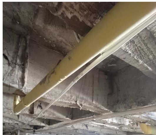
Figura 9. Fuga en las tuberías. Por S. Coll y J. Cervantes, 2017
