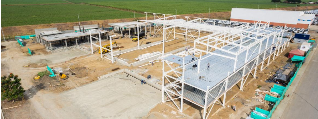
Figura 4. Obra expansión de la cervecería. . Adaptado de “Proyecto Montaje cocina continua cervecería del valle” Por fotomanager, 2015. Recuperado de http://fotomanager.co/proyectos/montaje-cocina-continua/
