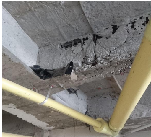
Figura 6. Acero de refuerzo expuesto. Por S. Coll y J. Cervantes, 2017
