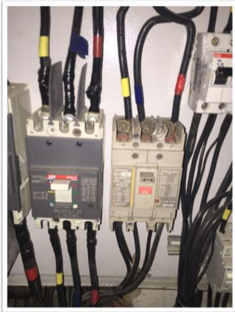
Protecciones principales de los aires acondicionados - segundo piso
