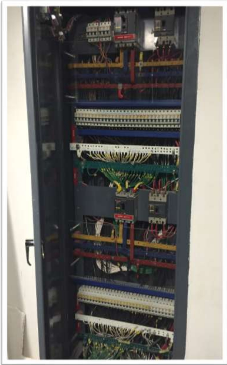
Protecciones de los circuitos generales
