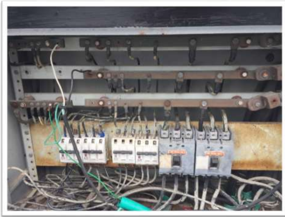
Protecciones principales de los aires acondicionados-primer piso
