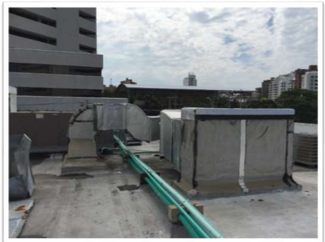
Paquetes de aires acondicionados ubicados en la azotea de la edificación.
