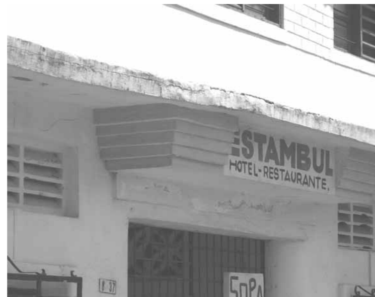
Foto 21. Detalle del antetecho sobre el vano del acceso principal, con un volumen escalonado descendente, de influencia Art Decó. Foto archivo del grupo de trabajo.
