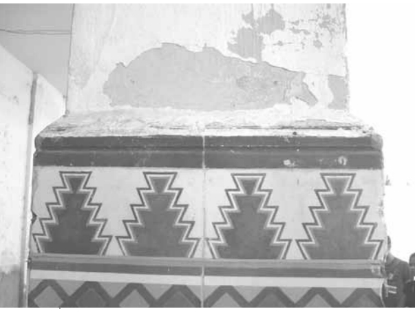
de una columna enchapada. Fotos archivo del grupo de trabajo. Fotos 17 y 18. Detalles de las figuras geométricas y colores que se aplicaron en los enchapes. Fotos archivo del grupo de trabajo.
