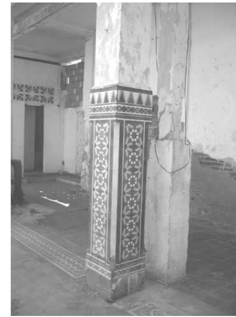
Fotos 15 y 16. Detalle de patología del concreto, y vista inferior
