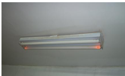
Figura 31. Luminaria en mal estado.
