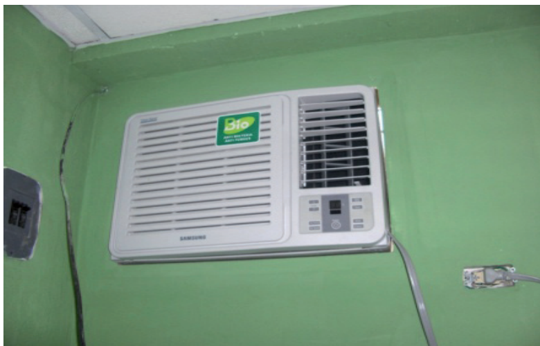
Figura 2. Equipos de climatización instalados en Colegio Distrital.
