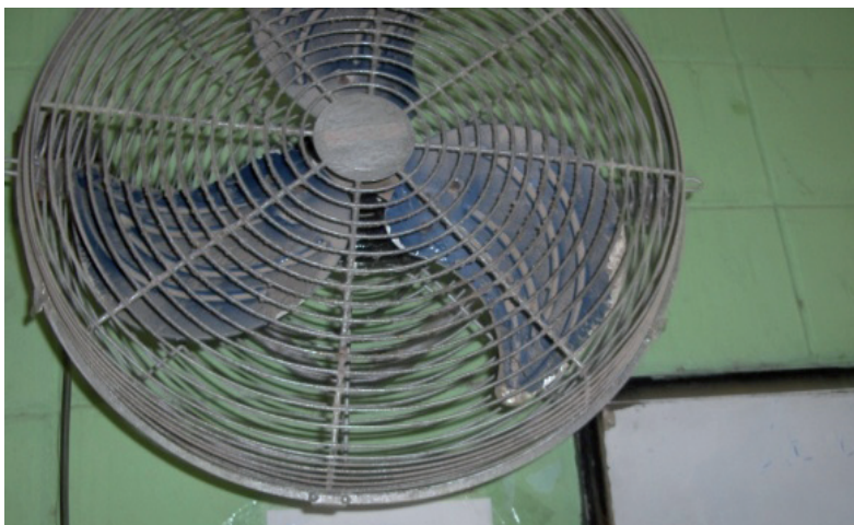
Figura 1. Equipos de ventilación instalados en Colegio Distrital.
