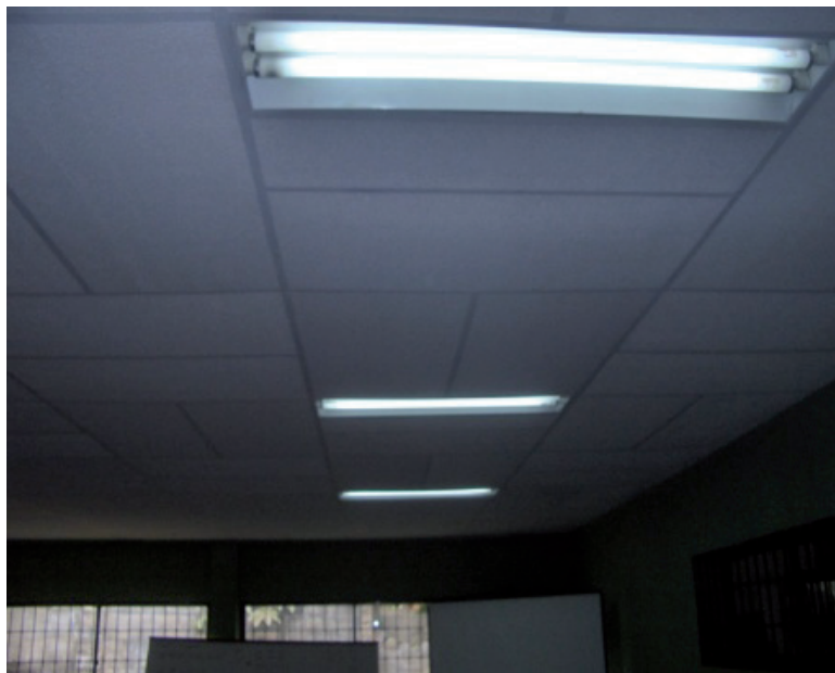
Figura 3. Luminarias instaladas en Colegio Distrital.
