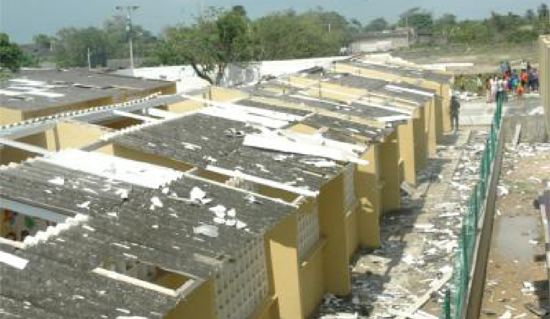
Figura 13. Casas destechada tras paso de tornado en Barranquilla en Mayo 22 del 2008 (RODRÍGUEZ, 2008)
