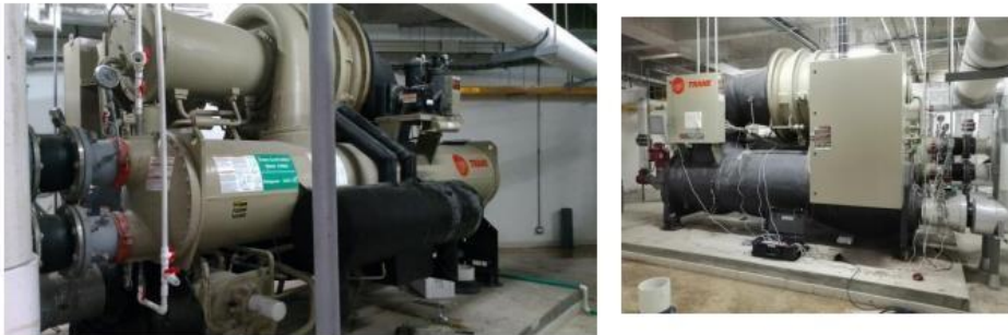
Figura 26. Chiller centrífugos Trane CVHE capacidad 380 toneladas. Fuente: Autor.
