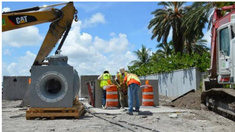
Figura 7. estación de bombeo en el sector de Miami Beach, Fuente (Herald, 2014).
