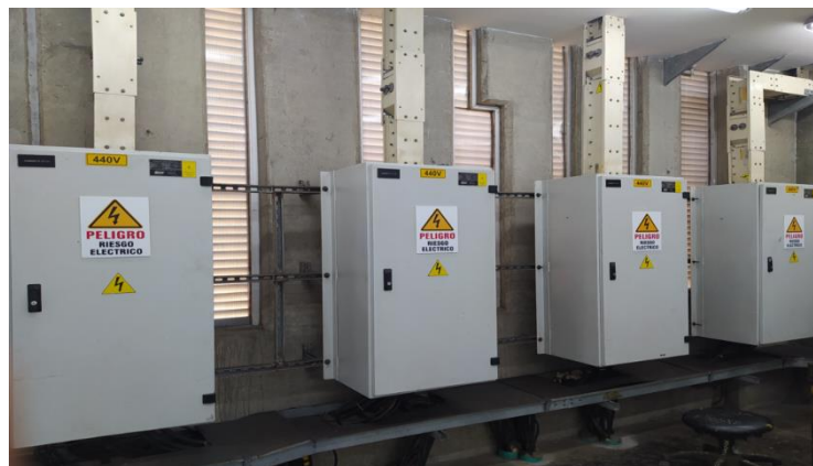
Figura 0.8 Subestación 3. Elaboración propia. 2022.
